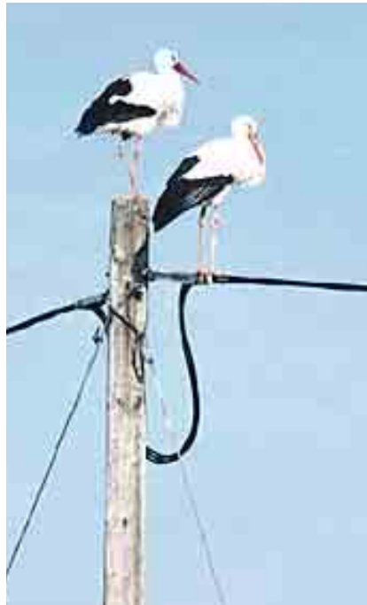
Парочка белых аистов на безопасной стоянке: хорошо изолированный кабель прикреплен без изоляторов прямо на мачте.
