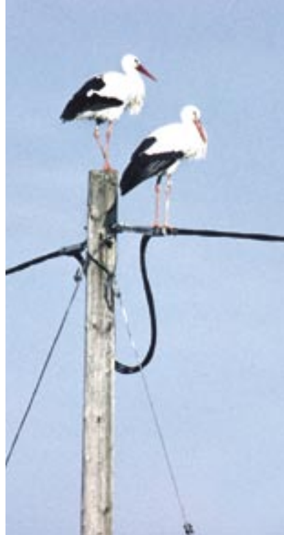
Dos Cigüeñas Blancas posadas en un lugar seguro: El cable aéreo aislado se ha sujetado directamente al poste sin usar aisladores.
