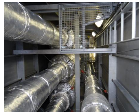
Partikelfilter im Schornstein der Heincke
