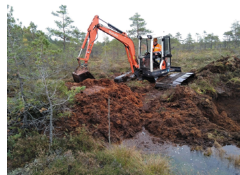
So können Maßnahmen zur Wiederherstellung von Mooren aussehen: In dem Projekt LIFE Peat Restore wurden zum Beispiel Grabenverschlüsse im lettischen Naturschutzgebiet Augstroze errichtet.
