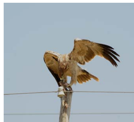
Nicht oder schlecht isolierte Stromleitungen sind für Zugvögel wie diesen Steppenadler eine tödliche Gefahr.
