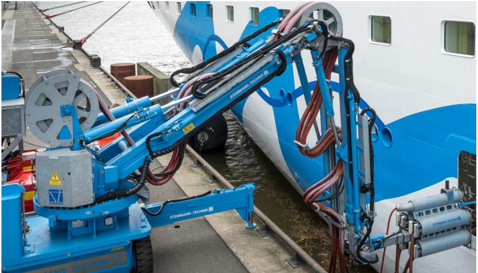
Landstromanlage im Hamburger Hafen
