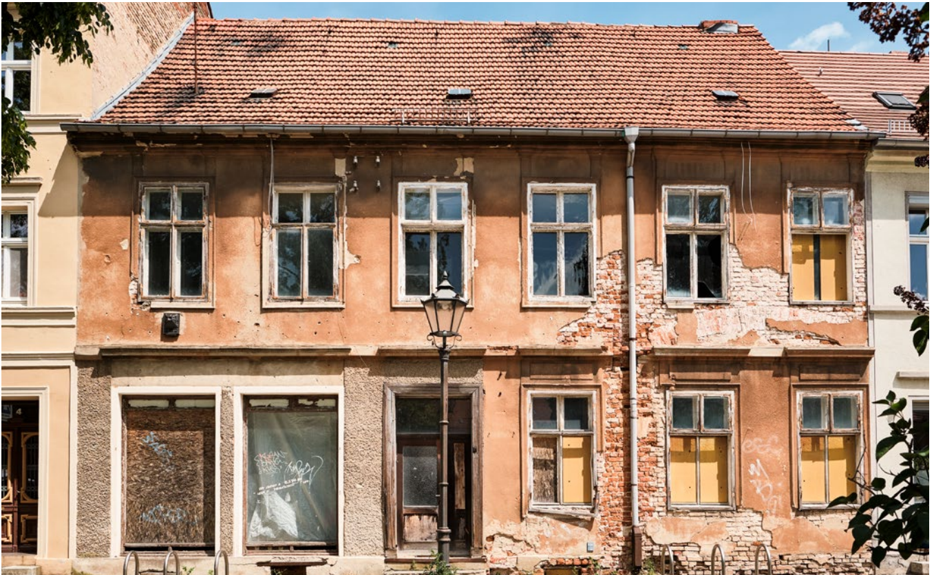
Vor allem in den neuen Bundesländern gibt es nach dem starken Bevölkerungsrückgang der letzten Jahrzehnte Leerstand, hier in Neuruppin.
