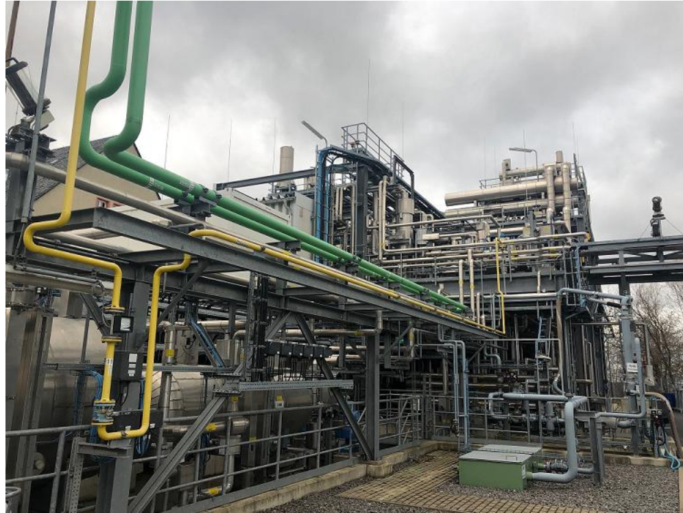
Gasifizierungsanlage an der TU Freiberg / Foto: NABU (S.Roth)
